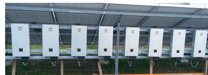
49.5kW 福岡県大川市
