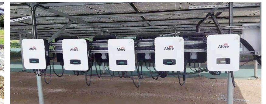
49.5kW 福岡県大川市
