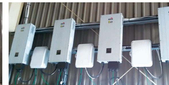
49.5kW 福岡県筑後市
