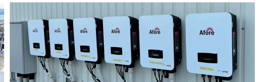
9.9kW 蓄電池:85.2kwh 59.4kW 福岡県
