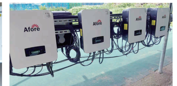
49.5kW 福岡県大川市
