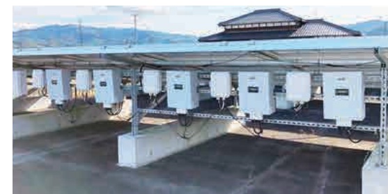
49.5kW 広島県福山市
