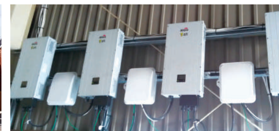
49.5kW 福岡県筑後市
