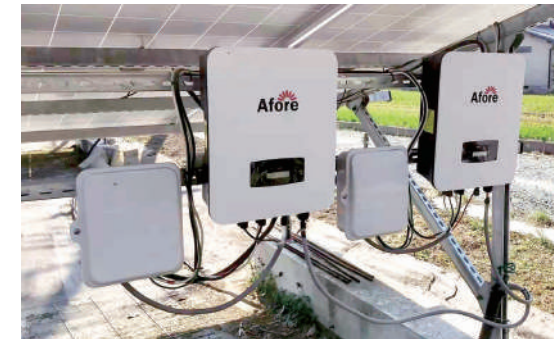
49.5kW 福岡県大川市
