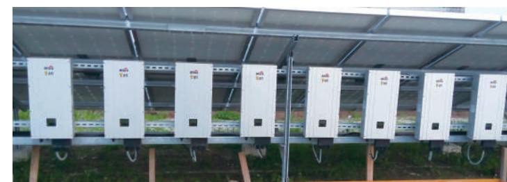
49.5kW 福岡県大川市
