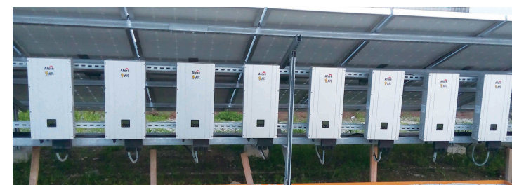
49.5kW 福岡県大川市
