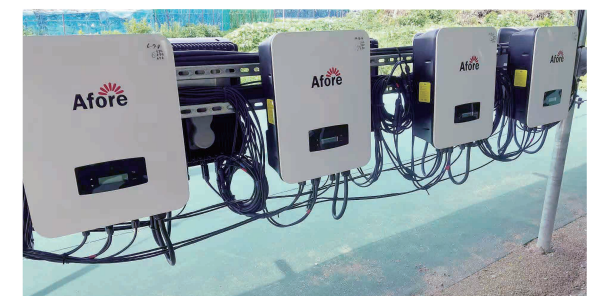
49.5kW 福岡県大川市
