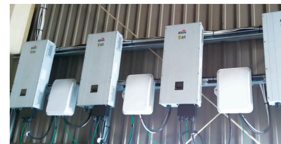
49.5kW 福岡県筑後市
