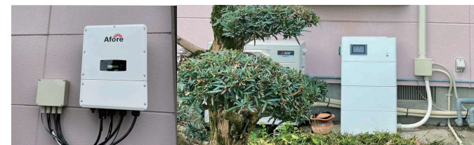
8.25kW 蓄電池:10kWh 日本福岡
