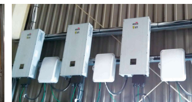
49.5kW 福岡県筑後市
