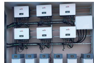
9.9kW 蓄電池:85.2kwh 59.4kW 福岡県宮若市
