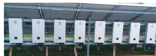
49.5kW 福岡県大川市
