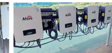
49.5kW 福岡県大川市
