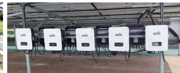
49.5kW 福岡県大川市
