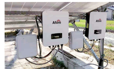
49.5kW 福岡県大川市
