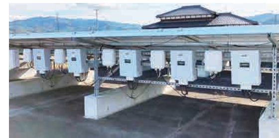
49.5kW 広島県福山市
