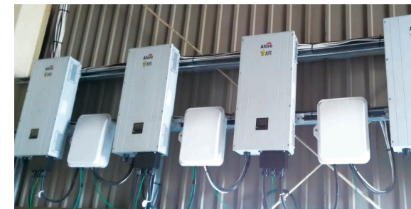
49.5kW 福岡県筑後市
