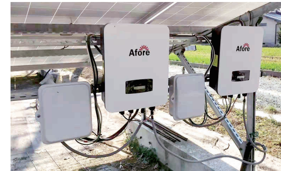
49.5kW 福岡県大川市
