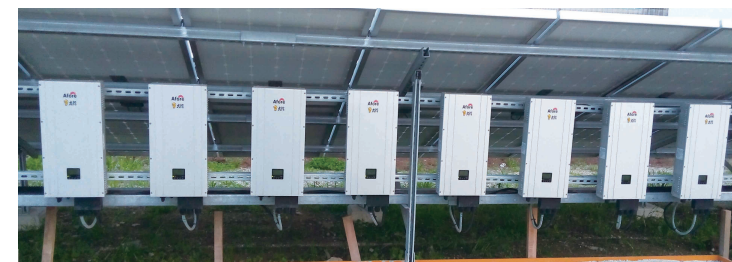
49.5kW 福岡県大川市
