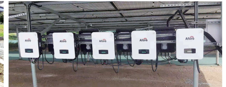
49.5kW 福岡県大川市
