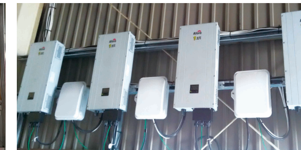
49.5kW 福岡県筑後市
