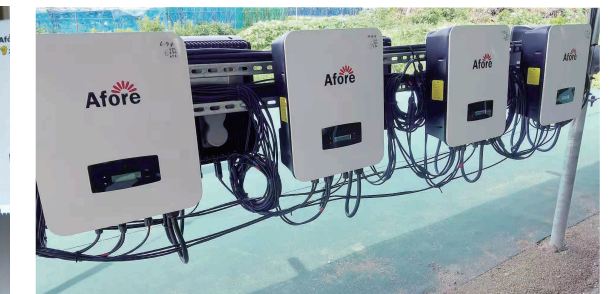
49.5kW 福岡県大川市
