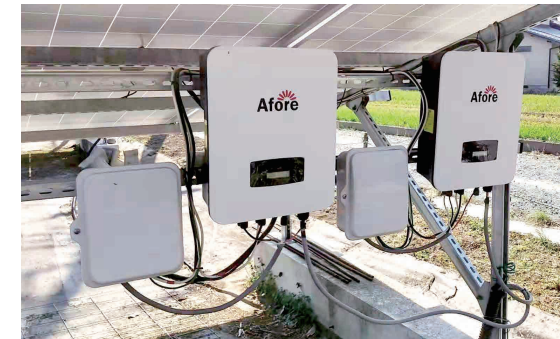
49.5kW 福岡県大川市
