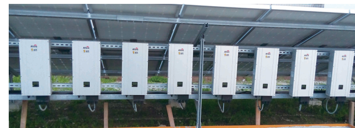
49.5kW 福岡県大川市
