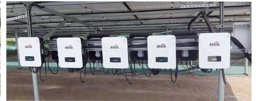
49.5kW 福岡県大川市
