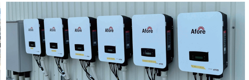
9.9kW 蓄電池:85.2kwh 59.4kW 福岡県
