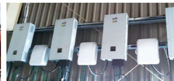
49.5kW 福岡県筑後市
