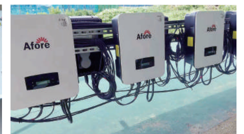
49.5kW 福岡県大川市
