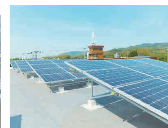
49.5kW 広島県福山市
