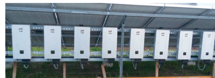
49.5kW 福岡県大川市
