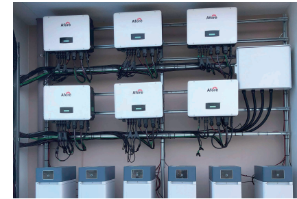
9.9kW 蓄電池:85.2kwh 59.4kW 福岡県宮若市
