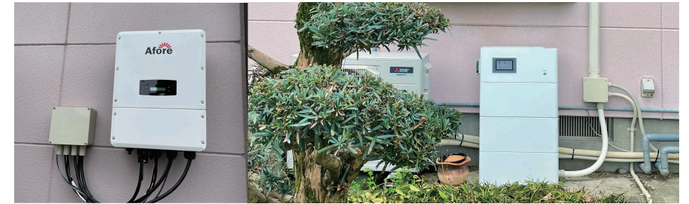
8.25kW 蓄電池:10kWh 日本福岡
