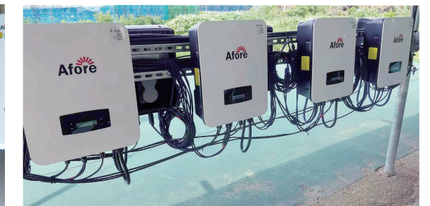
49.5kW 福岡県大川市
