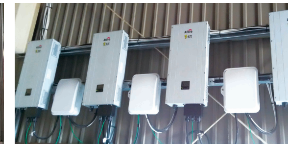
49.5kW 福岡県筑後市
