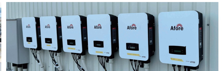
9.9kW 蓄電池:85.2kwh 59.4kW 福岡県
