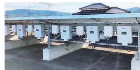
49.5kW 広島県福山市
