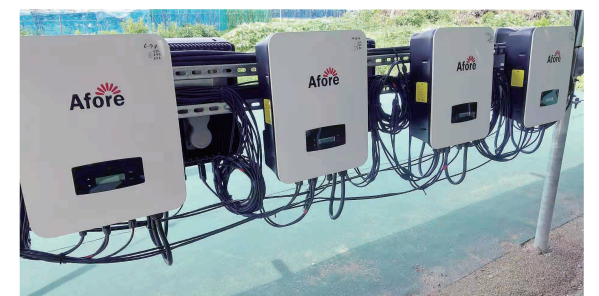
49.5kW 福岡県大川市
