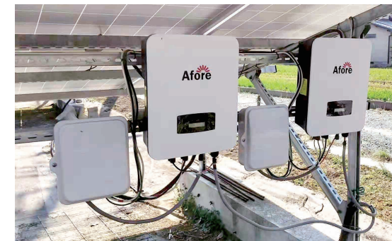
49.5kW 福岡県大川市
