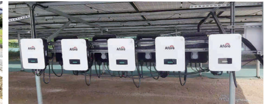
49.5kW 福岡県大川市
