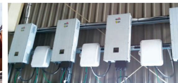
49.5kW 福岡県筑後市
