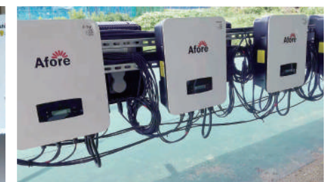
49.5kW 福岡県大川市
