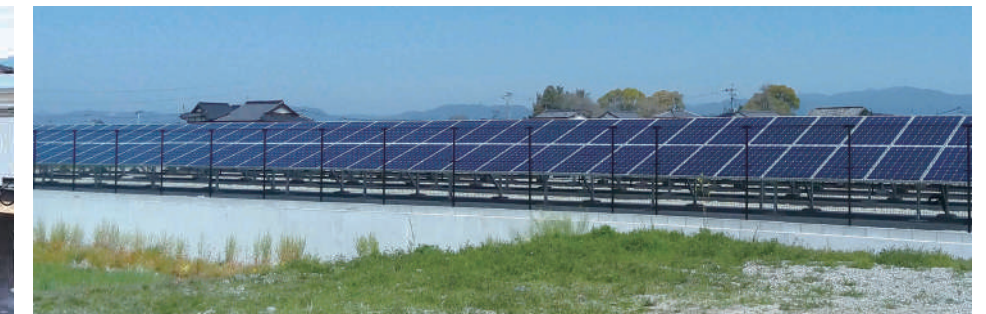
49.5kW 福岡県大川市
