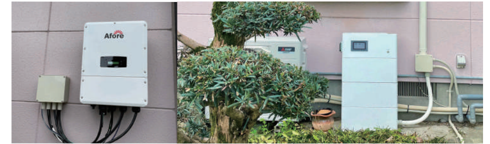
8.25kW 蓄電池:10kWh 日本福岡
