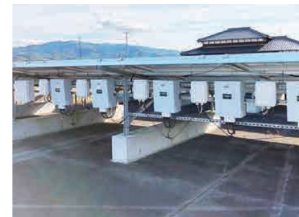
49.5kW 広島県福山市
