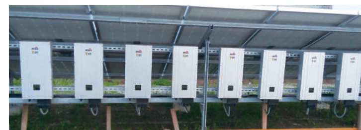
49.5kW 福岡県大川市
