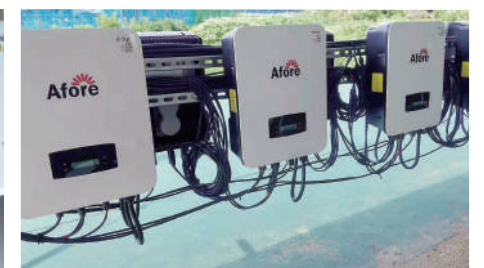
49.5kW 福岡県大川市
