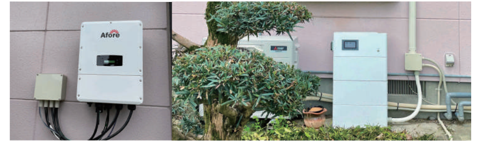
8.25kW 蓄電池:10kWh 日本福岡
