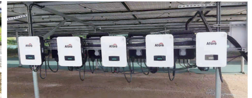
49.5kW 福岡県大川市
