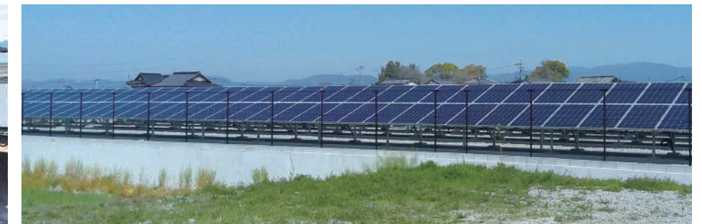
49.5kW 福岡県大川市
