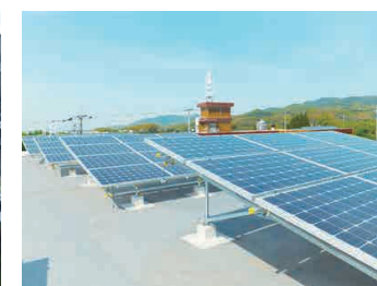
49.5kW 広島県福山市
