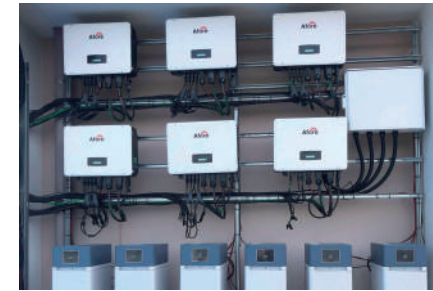
59.4kW 蓄電池:85.2kwh 福岡県宮若市
